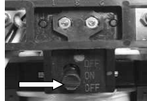
Diafragma-beschermings-schakelaar geactiveerd. (Pomp draait niet.)
